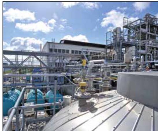
Außenanlage (Produktion) mit Betriebsbehältern und Lagertanks
