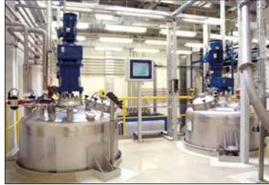
Misch- und Ansatz tanks zur vollautomatischen Herstellung von Basisorganosolen (= Lack)
